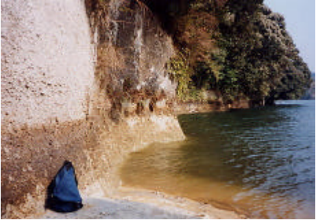
写真-1 高隈ダムでの斜面崩壊状況
