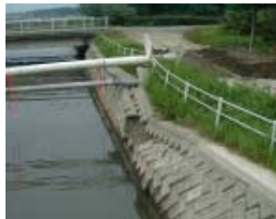
写真-1 流動による護岸の変状
