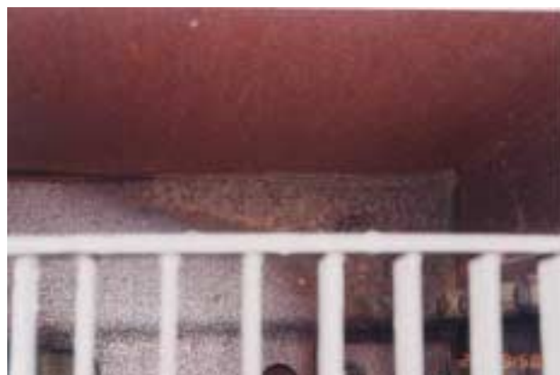
写真-2 層状剥離さび（桁端部）
