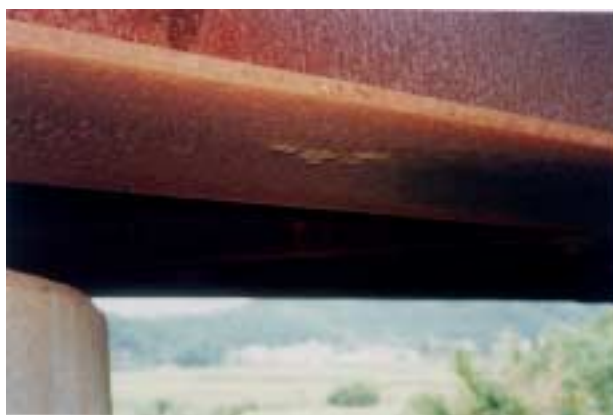
写真-1 層状剥離さび（下フランジ下面）
