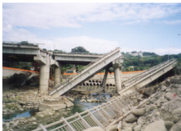
写真 - 1 石圍橋の被害
