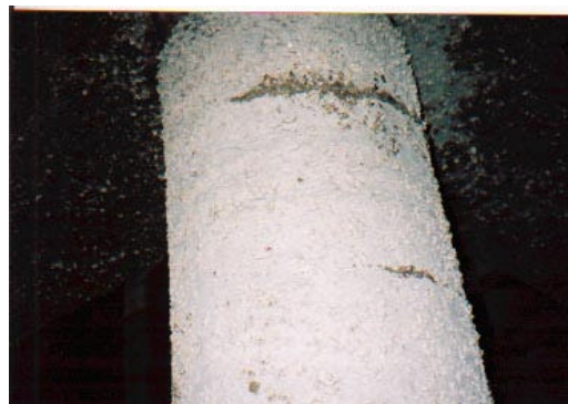
写真-3 RC 杭の被害状況(直杭に生じたクラック)
