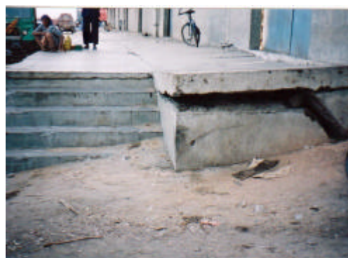
写真-5 液状化による上屋の被害
