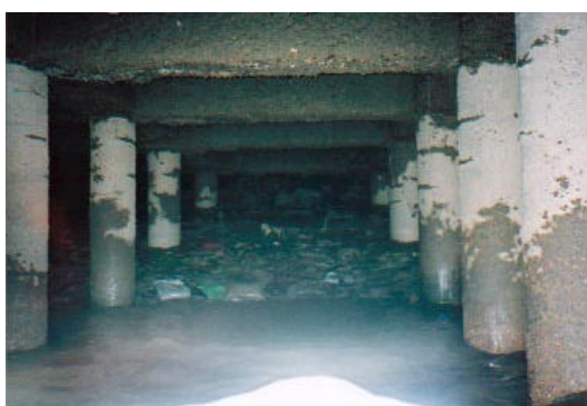
写真-2 RC 杭の被害状況(直杭に生じたクラック)
