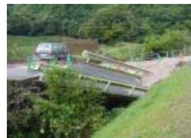
図-6 落橋の状況
