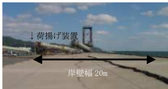
図-1 岸壁の沈下の状況
