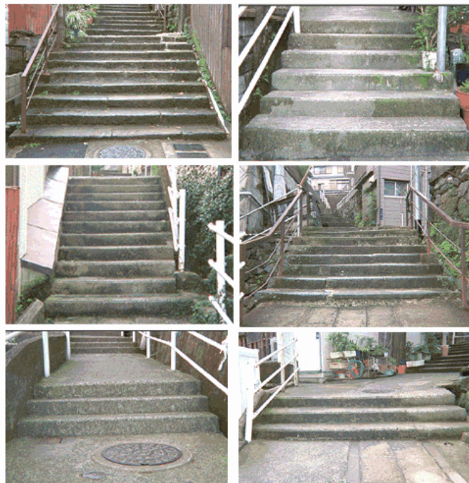
図-1 調査対象石段の一部
