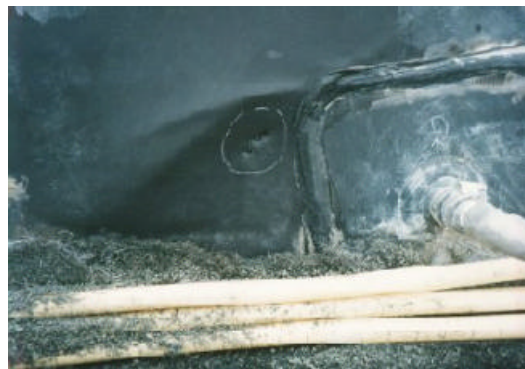
写真－１ 法面部シートの打傷痕
