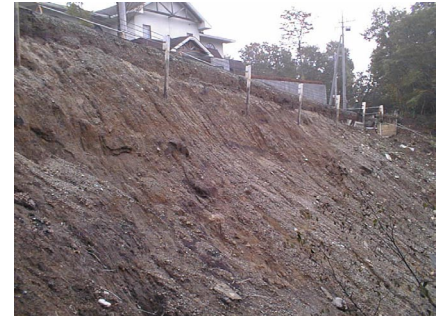
写真-1 被災状況
