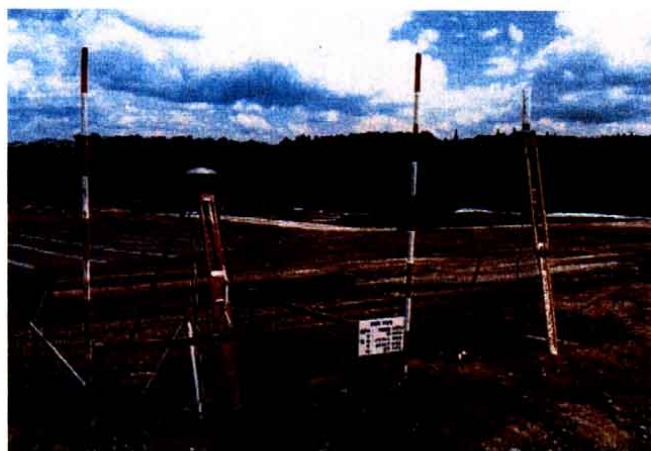
写真—2 固定局（GPSアンテナ）
