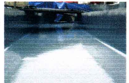
写真-2 勾配1/800の流雪溝
