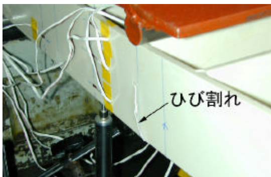
写真1 ひび割れ発生状況
