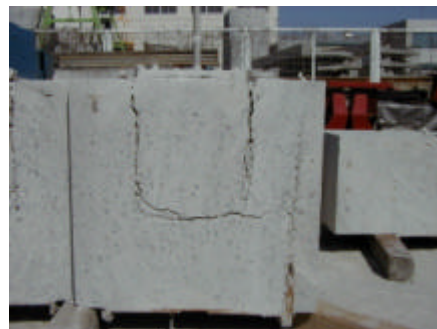
図3 ひび割れ(切断面)
