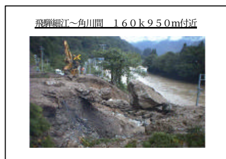
写真 1 160km950m 盛土流失
