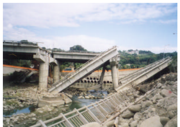
写真 - 1 石圍橋の被害
