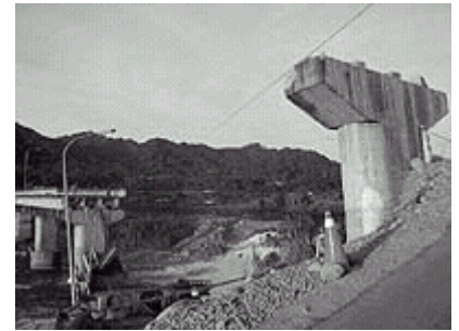
写真-1 隆起による碑豊橋の落橋
