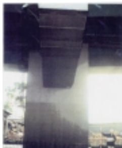
(a) P270 橋脚の損傷状況
