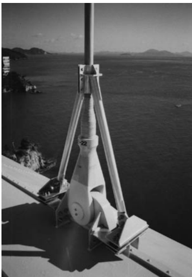
写真1 制振装置完成形
