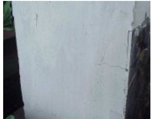
写真-1 クラックの発生(鉄筋降伏時)
