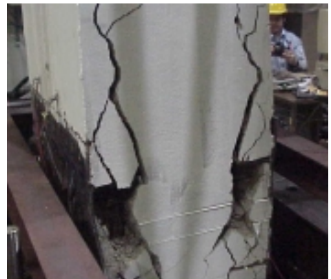
写真-2 コンクリートの破壊状況
