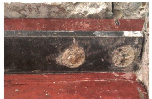
写真-2 破壊状況(鉄筋なし，板厚 16mm)
