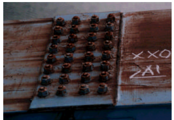
写真-1 ボルトの劣化状況
