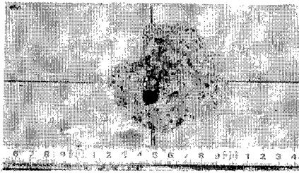
写真1 コンクリートの剥離形状
