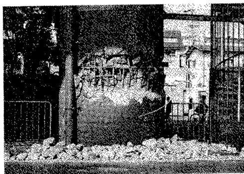
写真2 高架橋 RC 橋脚の圧縮破壊
