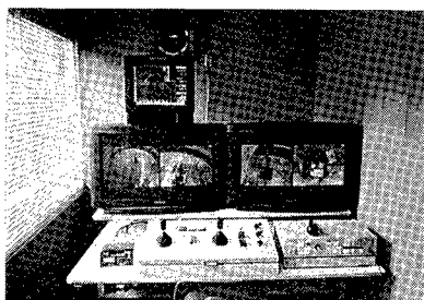
写真-1 操作側機器配置
