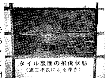
写真-6 タイル裏面の損傷状態
