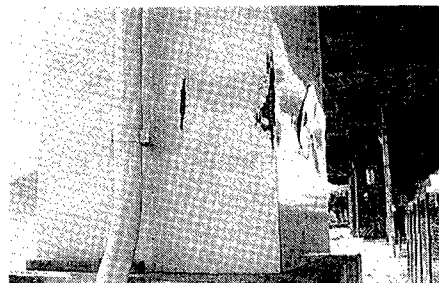
写真-2 矩形断面鋼製橋脚の座屈
