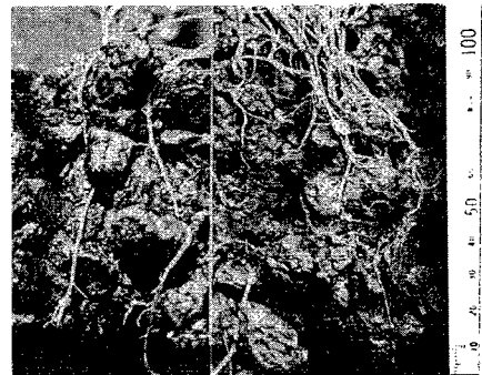
写真-2 植物の根の侵入状態 (PoC: 5号)
