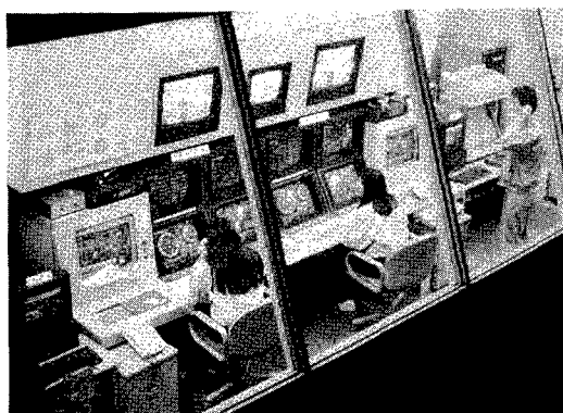
写真-1 中央制御室状況
