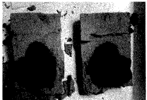
写真-1 浸水状況
