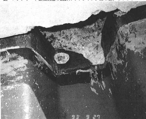
写真-1：C-2体の接合部周囲のコンクリート滑落部
