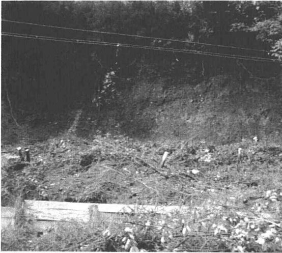
写真－２ 計測対象の崩壊法面
