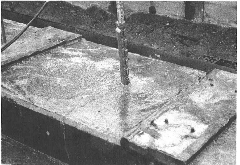
写真-2 仮設桁の破碎状況
