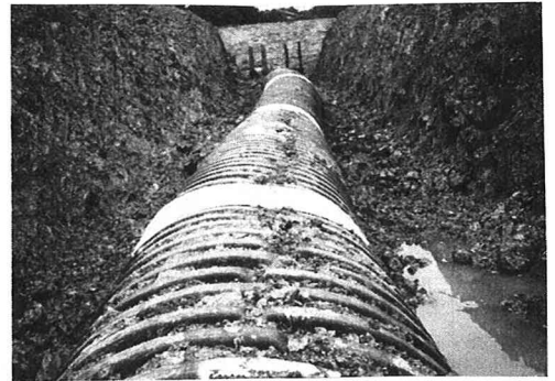
図-1 HDPE管の破損状況
