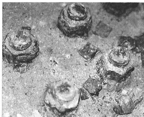
写真－1 実橋における高力ボルトの腐食事例 （漏水による箱桁内部の腐食）
