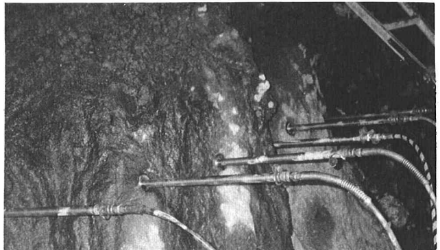
写真-2 破碎状況
