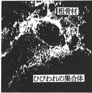
写真-1 モルタルひびわれ(10倍)
