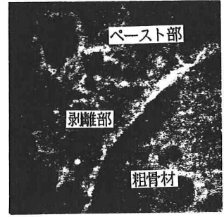
写真-3 骨材の剥離状況(10倍)
