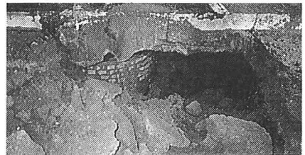
写真-5 空洞箇所の開削状況例 空洞規模：縦3m×横3m×深さ1m 空洞発生原因：下水管継手破損による土砂流失
