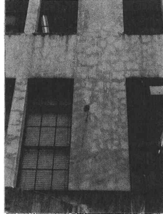
写真-1 劣化した構造物
