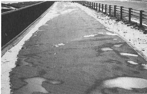
写真-1 EPS盛土部と在来盛土の境界部での亀裂（釧路町別保地区）
