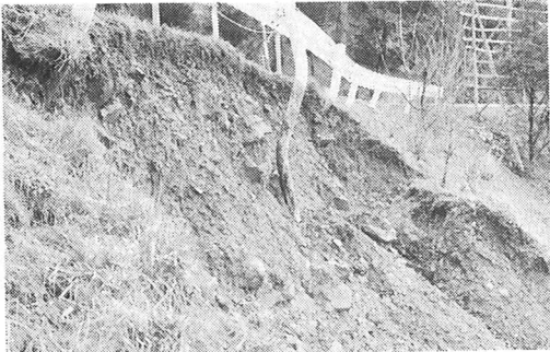
写真-2 地震による斜面崩壊（輪島市千枚田地区）
