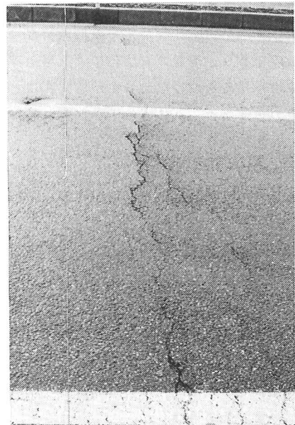
写真-3 EPS盛土部と在来盛土の境界部での亀裂（輪島市千枚田地区）
