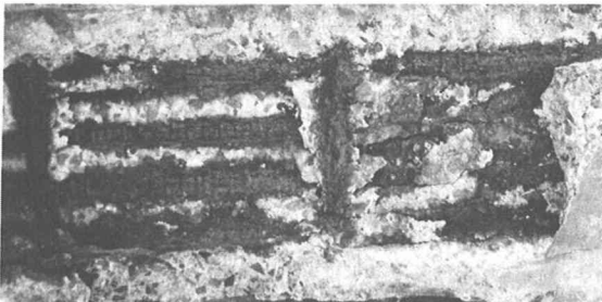
写真-2 はり下部の鉄筋の腐食状況
