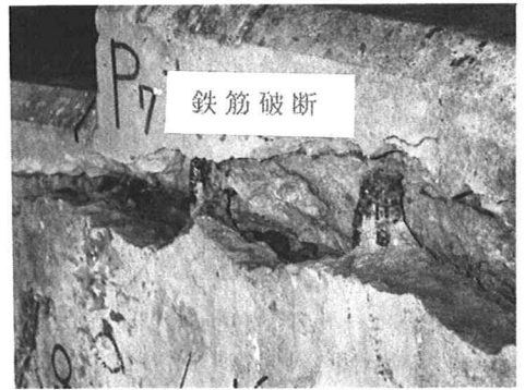
写真-1 橋脚上部の損傷状況
