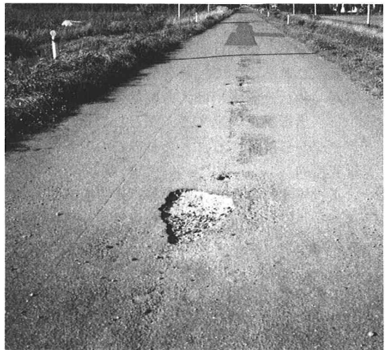
写真-4 交通車両等による路面剥離
