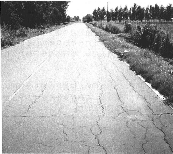
写真-3 地盤沈下によるクラック
