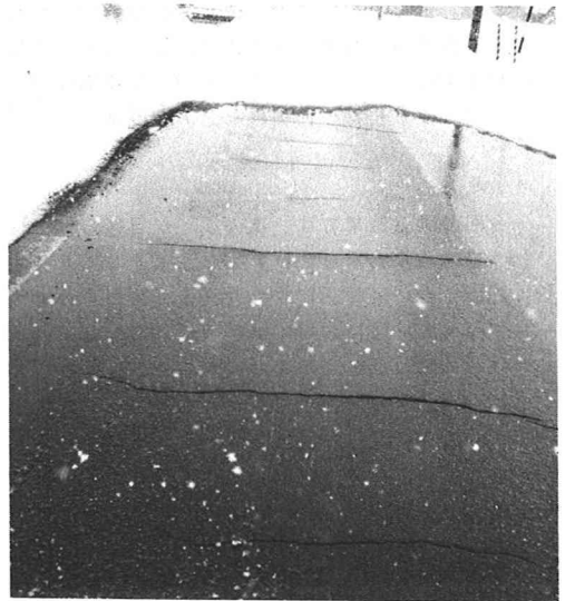
写真-2 温度応力クラック
