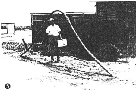
図1. 液状化地盤でのガス管の座屈変形
