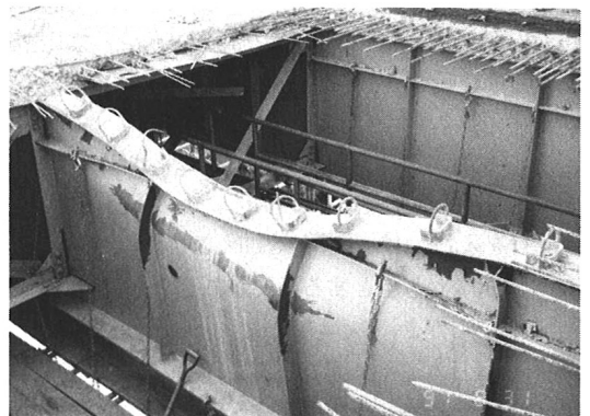
写真-1 桁の損傷状況
