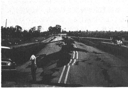
写真1 道路盛土の被害
