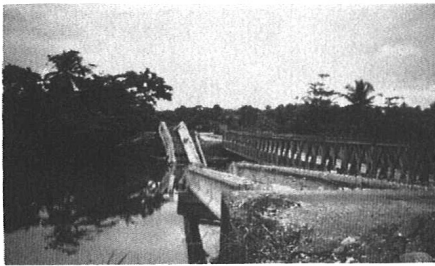
写真2 Viscaya川に架かる橋の被害
