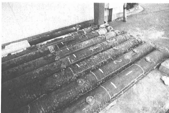
写真1 塗覆装の剥がれ(手前からNo.1)
