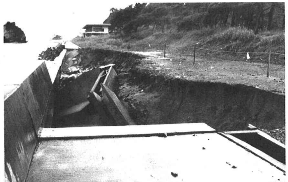
写真-2 護岸の被災後4日の状況(1990年10月29日撮影)
