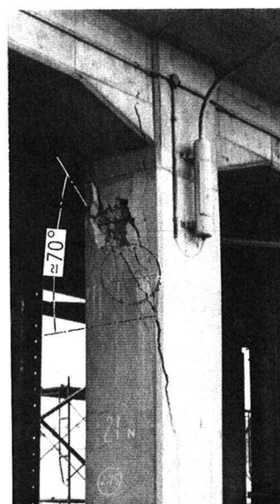
図-1 斜めせん断ひびわれ震災例
