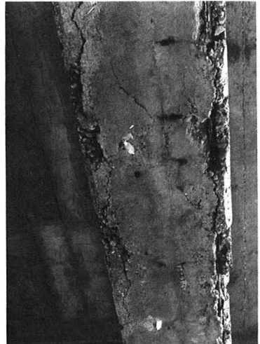
写真-1 縦ひびわれ発生したRC橋
