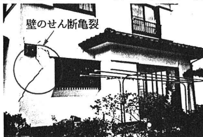
写真-1 崖地上の家屋の被害
